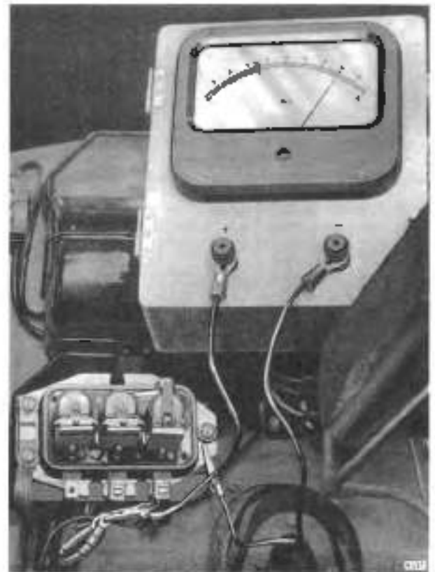
Fig. M5 Generator voltage test
